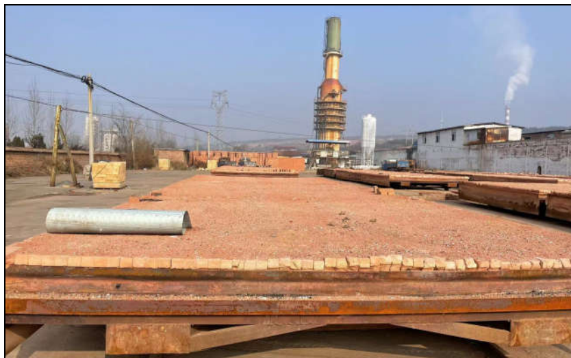
照片 8-3 东北部脱硫池
